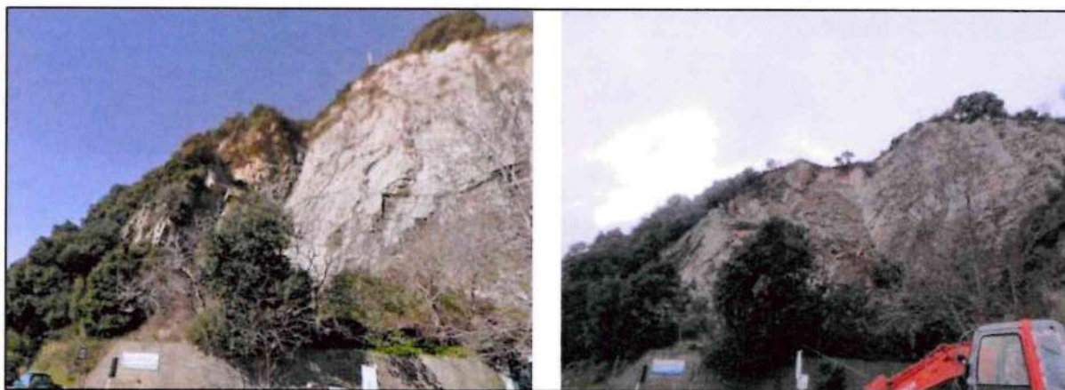
Figura 1. Dalla sinistra verso destra: situazione ante e post fenomeno franoso del marzo 2016 (Fonte: Perizia tecnica sullo stato dei luoghi interessati dai lavori di consolidamento frana di Arenzano SS1 Aurelia, progr. 574+700, Dott. Geol. Salti Luca).
