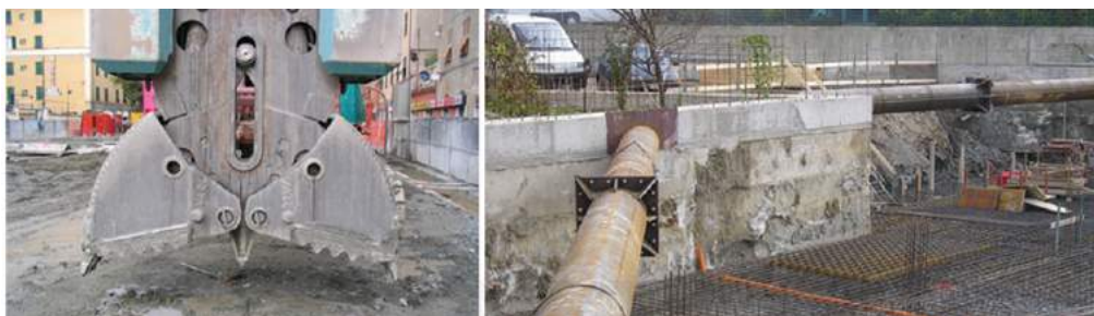
Documentazione esemplificativa fotografica della tecnologia adottata
